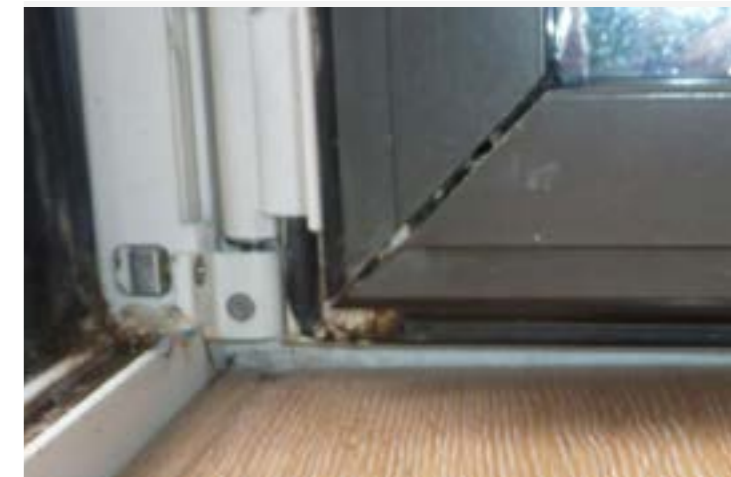
Assemblage d'angle défaillant et laissant apparaître des défauts de calfeutrement (Crédit photo: Saretec)
