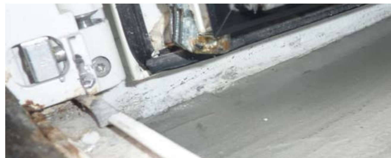
Déformation d'une contre-plaque de paumelle, précédant la chute du vantail. (Crédit photo: Saretec)
