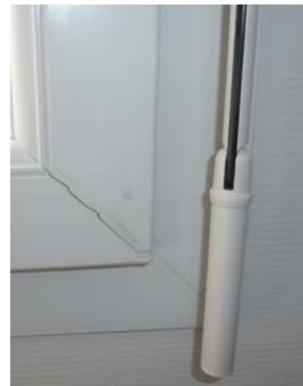
Rupture de soudure d'un angle de cadre PVC (Crédit photo: Saretec)
