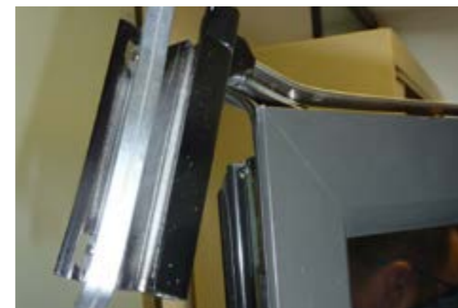
Arrachement de paumelle haute de châssis oscillo-battant (Crédit photo: Saretec)
