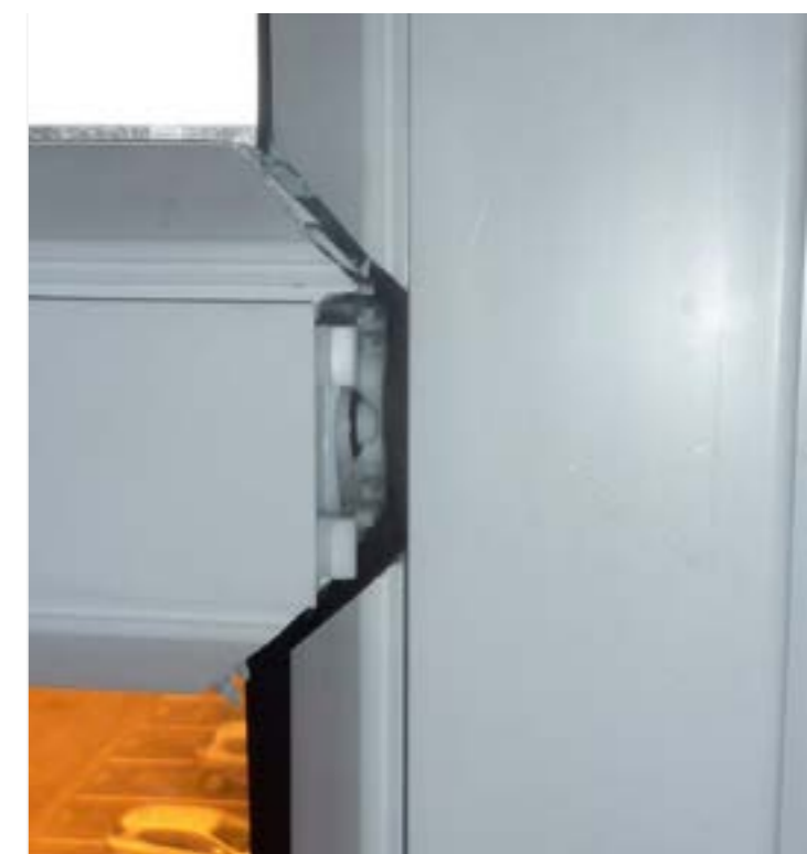
Rupture d'un assemblage mécanique en menuiserie PVC (Crédit photo: Saretec)
