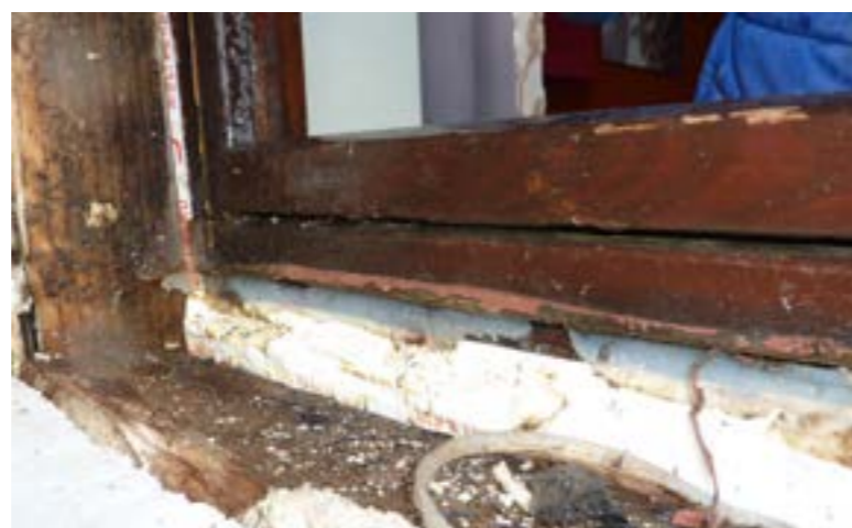
Effets de la rétention d'eau sous l'isolant en technique d'ITE (Crédit photo: Saretec)
